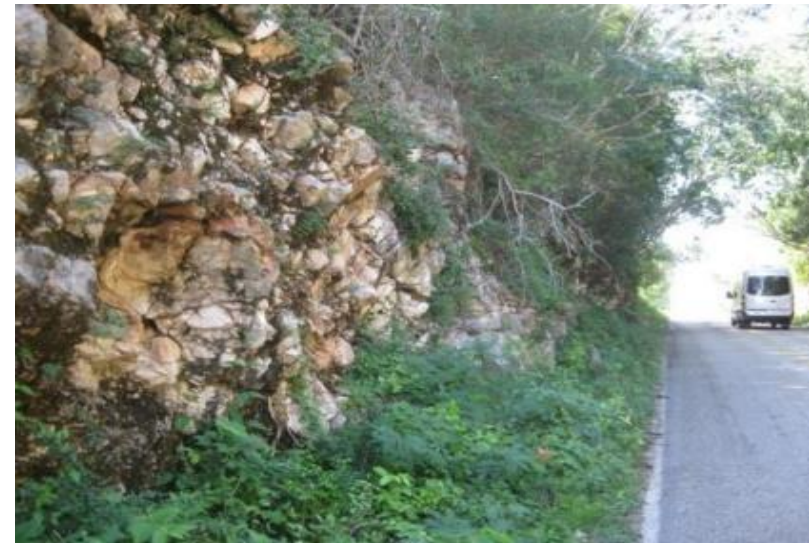
Ilustración 39.- Talud sobre camino pavimentado con flujo constante de vehículos, el macizo rocoso se encuentra altamente fracturado, lo que provoca pequeños bloques que caen sobre camino.
